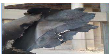
نمایی از پارگی خط لوله
