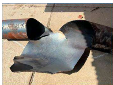
شکل ۲- پارگی خط لوله
