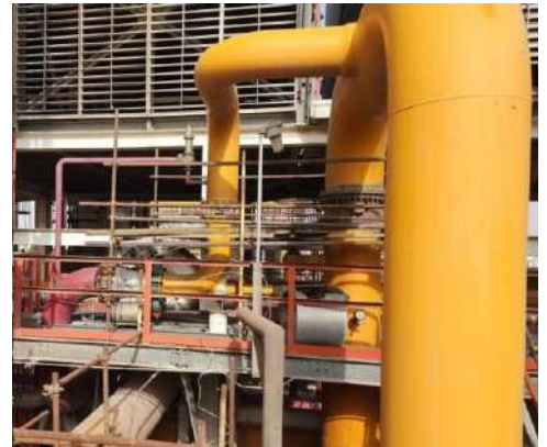
شیر کنترل فشار بالای ظرف رفلاکس
