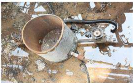
BOX-12 تهیه شده جهت نصب در محل نشت
