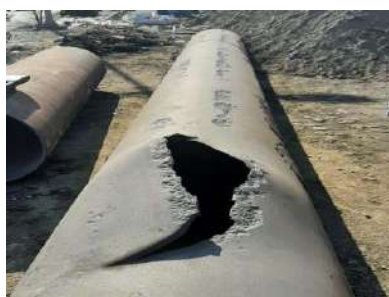
شکل ۲- پارگی خط لوله
