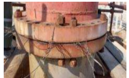
تخریب گسکت فلنج
