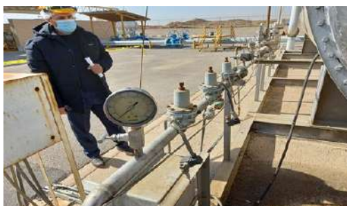
سیستم کنترل هیتر حادثه دیده
