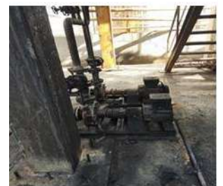
آثار سوختگی تاسیسات ناشی از آتش سوزی
